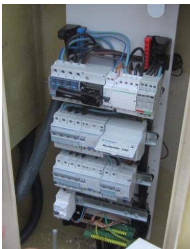
Armoire électrique d'éclairage public
